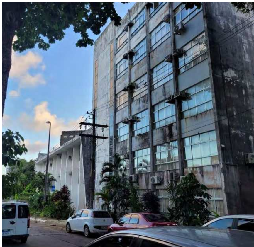
Figura 10. Vista externa do edifício e do anexo de 6 pavimentos. Fonte: Elaborado pelas autoras em maio de 2024.
