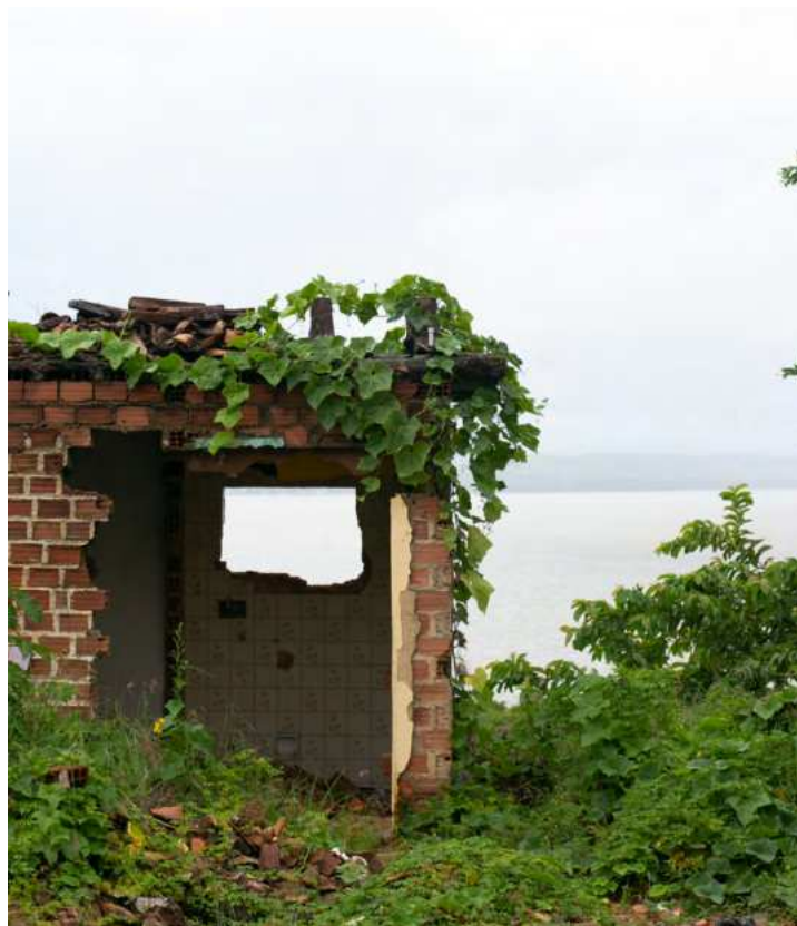
Figura 2: Situação atual dos bairros e suas residências, quando ainda não foram demolidas estão totalmente arruinados. Fonte: Tamires Cassella, 2024.
