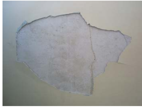
Figura 09: Revestimento interno em péssimo estado de conservação. Fonte: foto do autor, 2007.
