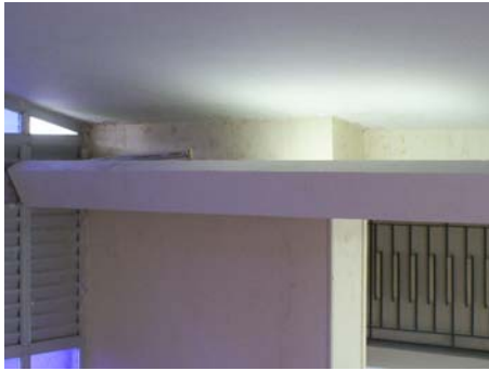
Figura 08: Infiltrações internas. Fonte: foto do autor, 2007.
