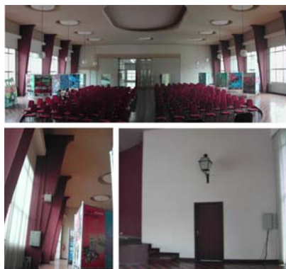
Figura 20 : fotos do Salão social e seu atual estado de conservação, deficiências no sistema elétrico e a cores adotadas
