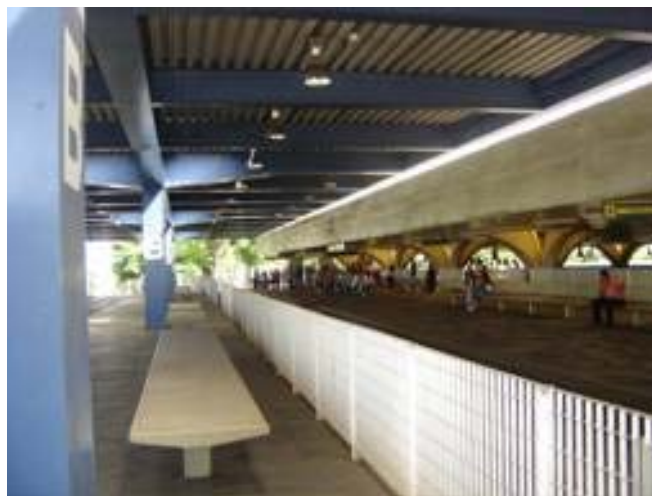
Foto 25 – Detalhe da sobreposição da cobertura do Terminal de Integração com a cobertura da Rodoviária de Jaú. Fonte: Corrêa, Paulo (2007).
