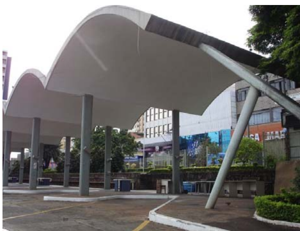
Foto 8 – Reforço em diagonal colocado na estrutura a posteriori . Fonte: PISANI, Maria Augusta Justi (2006)
