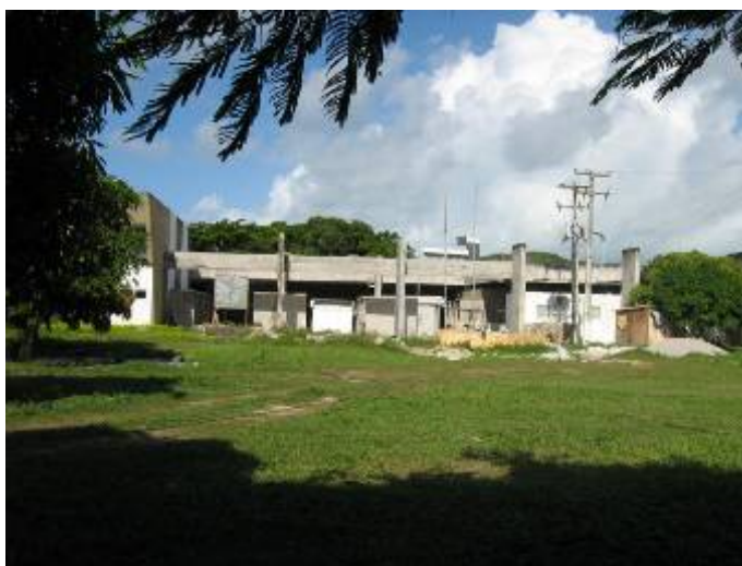
Figura 16: Vista dos fundos das salas voltadas para a reitoria. Negação da transparência que caracterizava a proposta inicial. Fonte: os autores, 2007.
