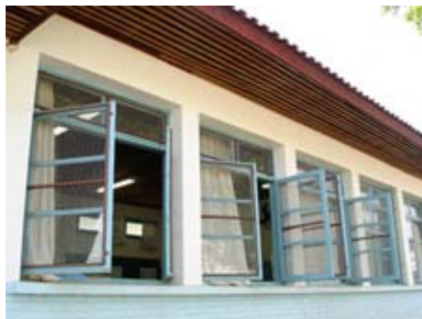
Figura 17 Salvador Candia, Grupo Escolar no Bairro de Cubatão, Itapira: esquadrias protegidas por telas
