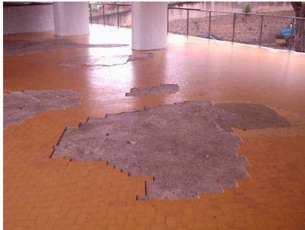
Figura 11. Detalhe do piso faltante no pavimento intermediário (Foto GAP)
