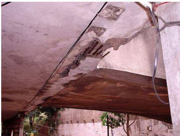
Figura 8. Detalhe da armação exposta na passarela do Bloco A (Foto GAP)
