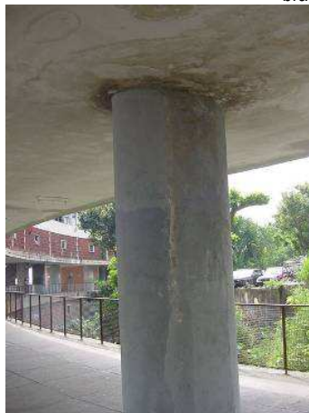
Figura 10. Detalhe da infiltração entre o pilar e a laje no pavimento intermediário (Foto Concrejato)
