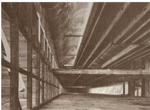
Figura 4: Museu de Arte moderna. Rio de Janeiro. 1954-1967. Interior em construção. Fonte: Bonduki, 1999.
