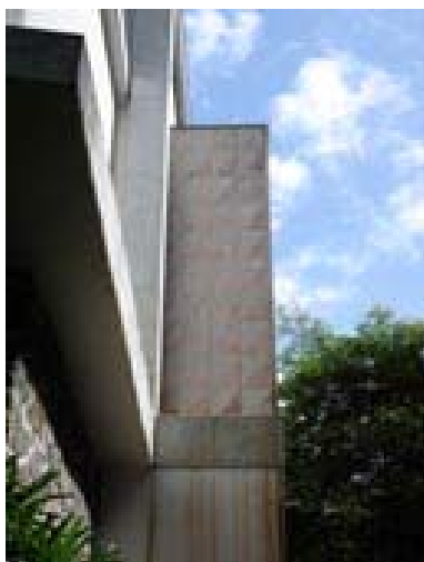
Fig. 08 – Manchas no mármore e na argamassa, causadas pela incidência de chuva.
