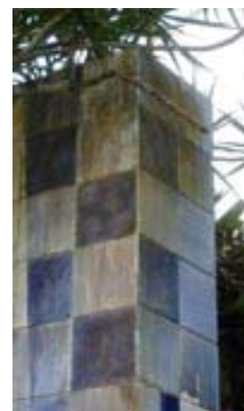
Fig. 20 – Topo da parede, onde foi colocada peça para diminuir a infiltração de água.
