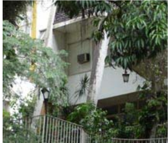
Fig. 29 – Manchas nas pastilhas, mas bom estado de conservação da veneziana na parede sob a laje de cobertura.
