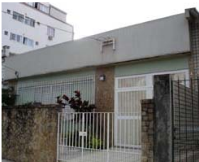
Fig. 33 – Escurecimento das pastilhas na parte inferior da platibanda e janela em alumínio.
