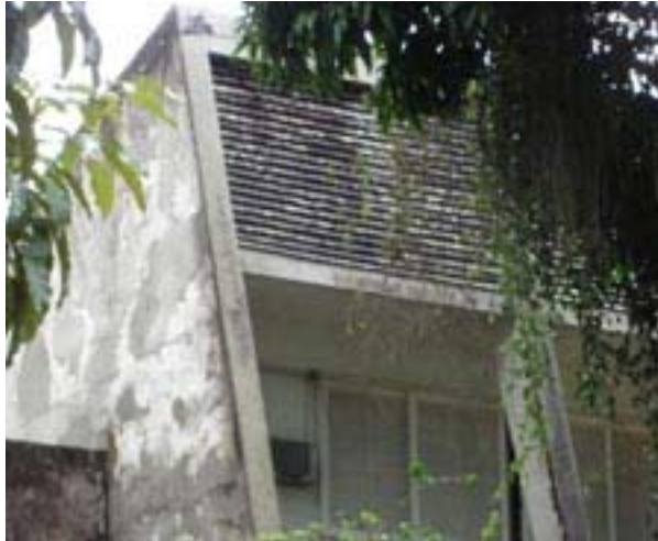
Fig. 28 – Manchas e rachaduras no revestimento de pastilhas e alto grau de deterioração da veneziana de madeira da parte superior.
