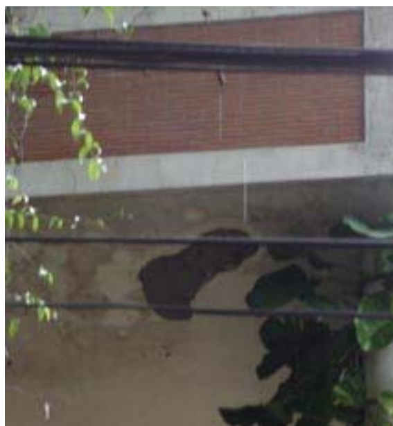
Fig. 27 – Parte inferior da laje, mostrando infiltrações causadas por problemas na impermeabilização.
