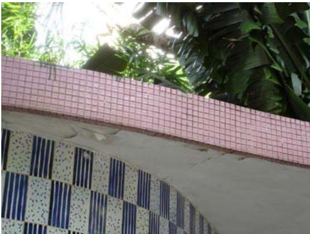
Fig. 24 – Guarita de entrada, com descolamento de pastilhas e escurecimento do rejunte.
