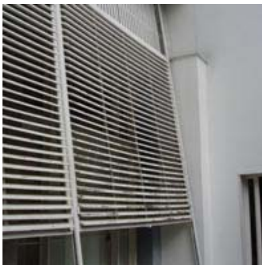
Fig. 15 – Veneziana junto ao lago. Deterioração da pintura.
