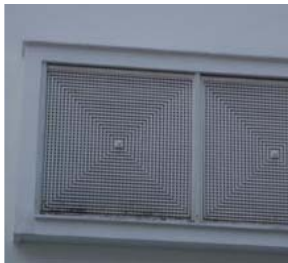
Fig. 16 – Treliça da antiga parte de serviço, apresentando manchas de umidade.
