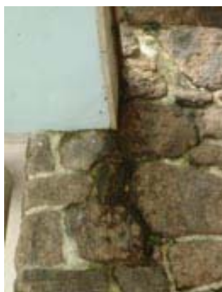
Fig. 04 – Manchas no encontro da laje com a parede em pedra.
