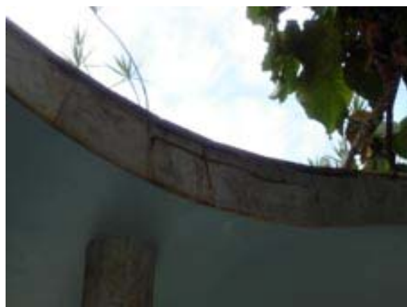
Fig. 05 – Rachaduras e manchas escuras no revestimento em mármore carrara.
