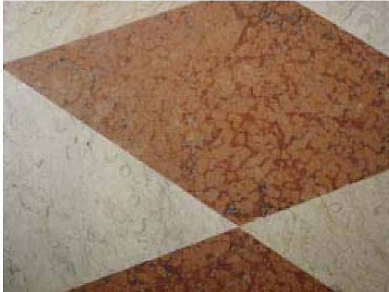
Fig. 21 – Piso em mármore, mostrando o desgaste da pedra.
