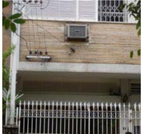
Fig. 32 – Manchas nas pastilhas mas bom estado de conservação das venezianas de madeira.
