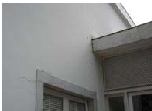
Fig. 10 – Manchas no revestimento da parede, em argamassa de cimento. No encontro da laje dos quartos.
