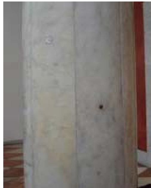
Fig. 23 – Coluna da entrada social, com manchas amareladas e desgaste, mostrando a existência de pino metálico.
