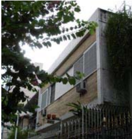
Fig. 31 – Parte da empena lateral, mostrando partes escurecidas por umidade e escurecimento das pastilhas.
