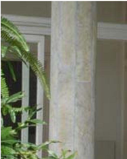
Fig. 22 – Manchas amareladas no revestimento em mármore carrara da coluna do pátio.
