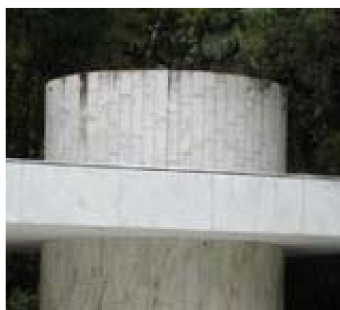
Fig. 11 – Manchas na parte superior do anexo da piscina, revestido em mármore branco.
