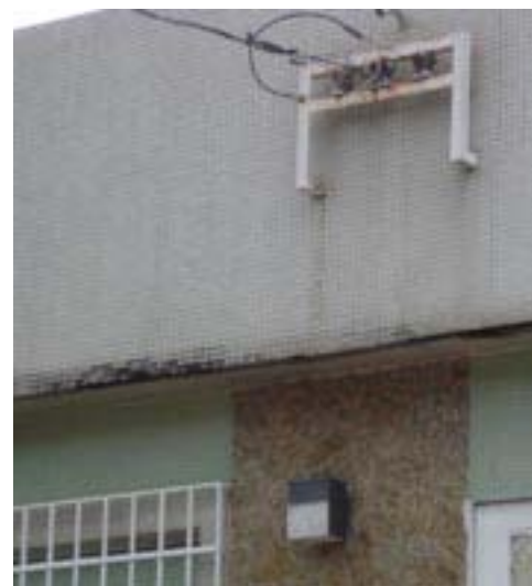
Fig. 34 – Descolamento de pastilhas e manchas.
