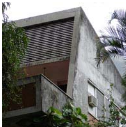
Fig. 26 – Lateral mostrando rachadura horizontal acima da janela.
