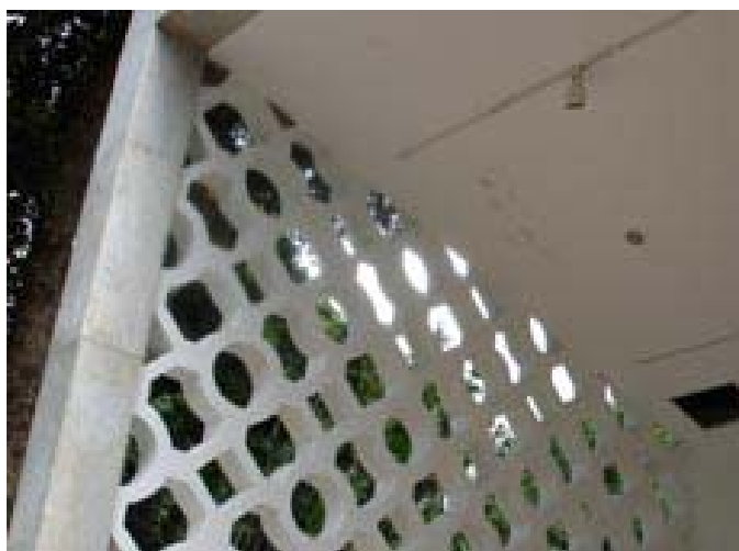
Fig. 09 – Início de infiltração na laje sobre a varanda apesar do cuidado constante com a impermeabilização.
