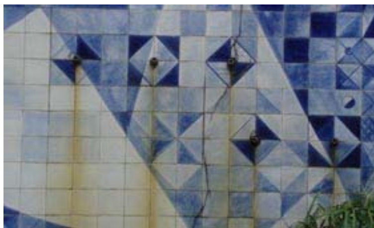
Fig. 19 – Manchas no painel causadas principalmente pelos tubos por onde sai a água que cai no lago e grandes rachaduras.
