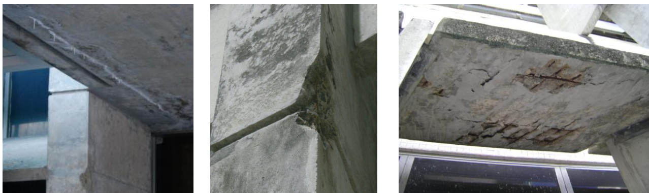
Figura 07: Eflorescências na marquise frontal. Edifício sede da CELPE. Foto: Bárbara Aguiar, 2009. Figuras 08 e 09: Deterioração de pilar e brise de concreto. Edifício sede da CELPE. Foto: Bárbara Aguiar, 2009 (08); CONCREPOXI, 2009 (09).
