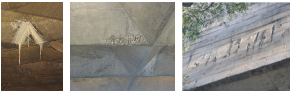
Figuras 11 a 13: Danos que acometem o edifício da FAUUSP. Eflorescência, corrosão de armaduras e destacamento do concreto, manchas causadas por poluição Fonte: Relatório PhD 136/2010 (2010).
