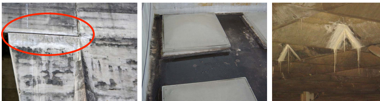
Figura 02: Pilar recuperado. Edifício Vilanova Artigas - FAUUSP. Fonte: Relatório Técnico PhD 136 / 2010. Figuras 03 e 04: Problemas observados na cobertura, rompimento da impermeabilização e acúmulo de água, eflorescências. Edifício Vilanova Artigas - FAUUSP. Fonte: Relatório Técnico PhD 136 / 2010 (2010).
