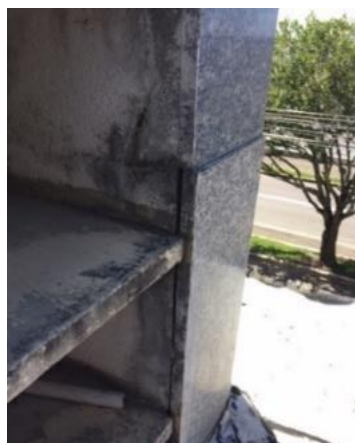
Figura 12: Descolamento de revestimento da fachada. Fonte: Rafaela Lima, 2017.
