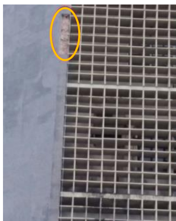
Figura 11: Indicação da perda do revestimento (granito) fachada. Fonte: Rafaela Lima, 2017.
