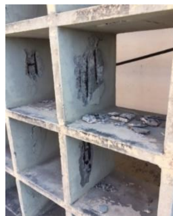
Figura 13: Esfacelamento da estrutura modulada. Fonte: Rafaela Lima, 2017.
